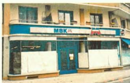
Le magasin, avenue de Chambéry, en cours de travaux, avant de devenir "Motocité".
